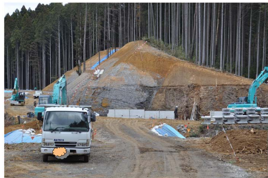
町道 町裏シウキ線 狐洞地点の道路工事法面に現れた断層(N80E) 西側から東向きに撮影
